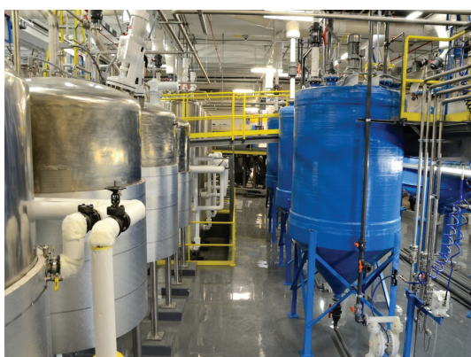
貴金属精錬設備（湿式）
