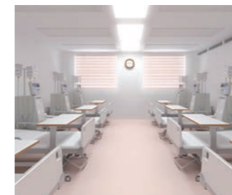
天井放射冷暖房システム
